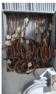
Ordenamiento de conductores
