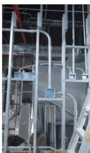
Canalizaciones y cajas eléctricas
