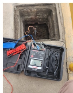
Medición de puesta a tierra
