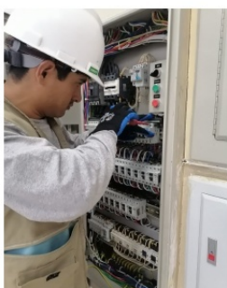
Verificación y mantenimiento eléctrico
